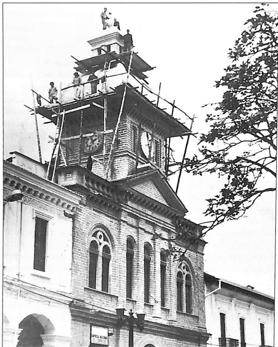
Foto 9: Intervención Torreón, vista general. Archivo Ing. Carlos Jaramillo V. 1994
