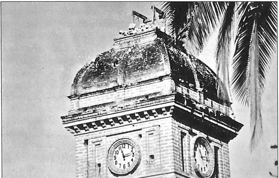
Foto 8: Bóveda y cupulín luego del sismo 05/03/87.
